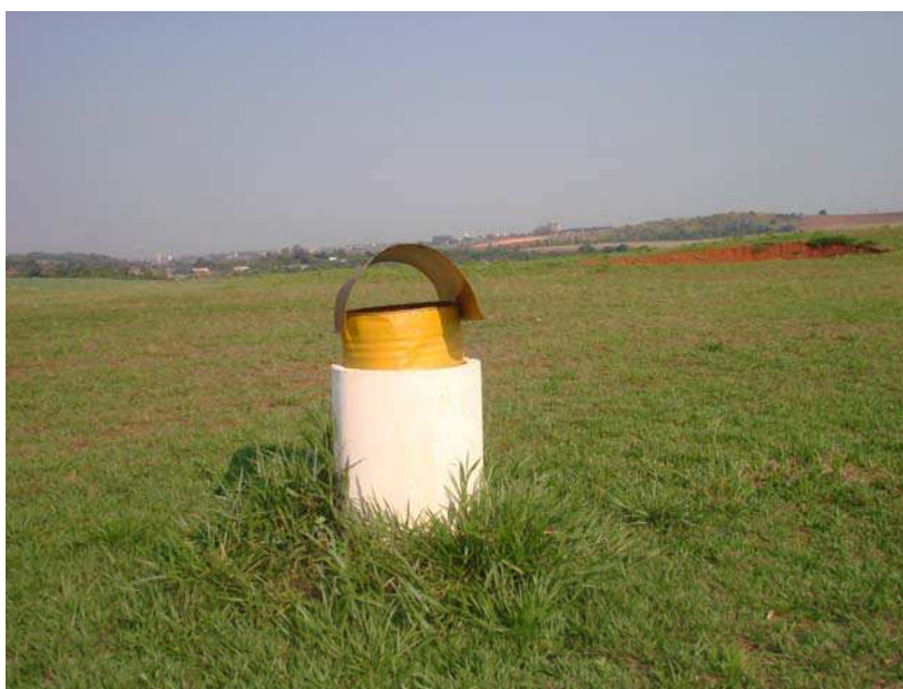
Figura 27 – Sistema de drenagem dos gases do Aterro Sanitário de Mogi Mirim – 25.11.2007. Fonte: Luís Augusto Bresser Dores, 2007, FMPFM, arquivo pessoal.
