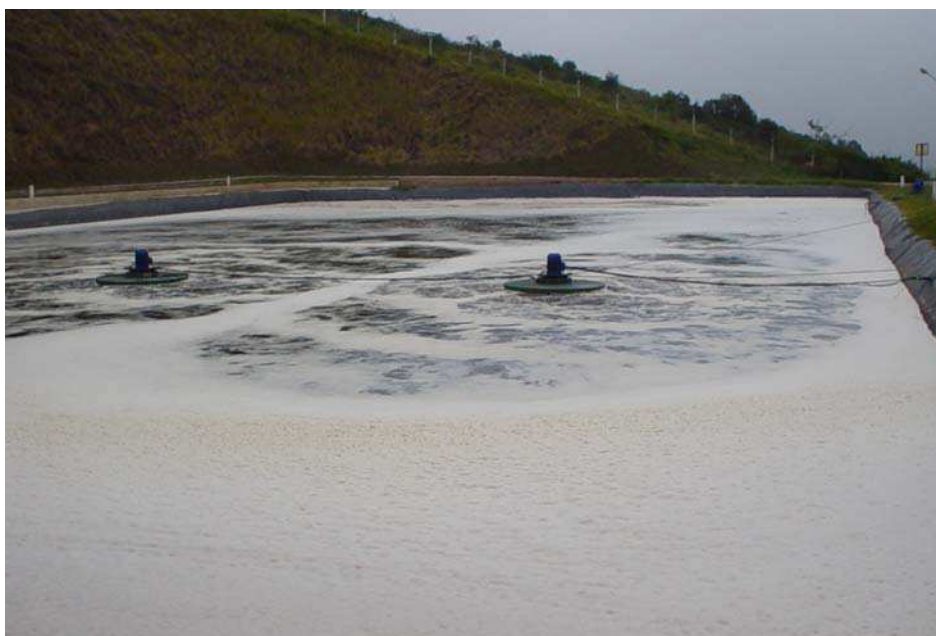
Figura 19: Exemplo de ETE (Estação de Tratamento de Efluentes) aeróbio de líquidos percolados (CHORUME) em aterro sanitário convencional. Fonte: Fernando Wolmer, 2007, CETESB, arquivo pessoal
