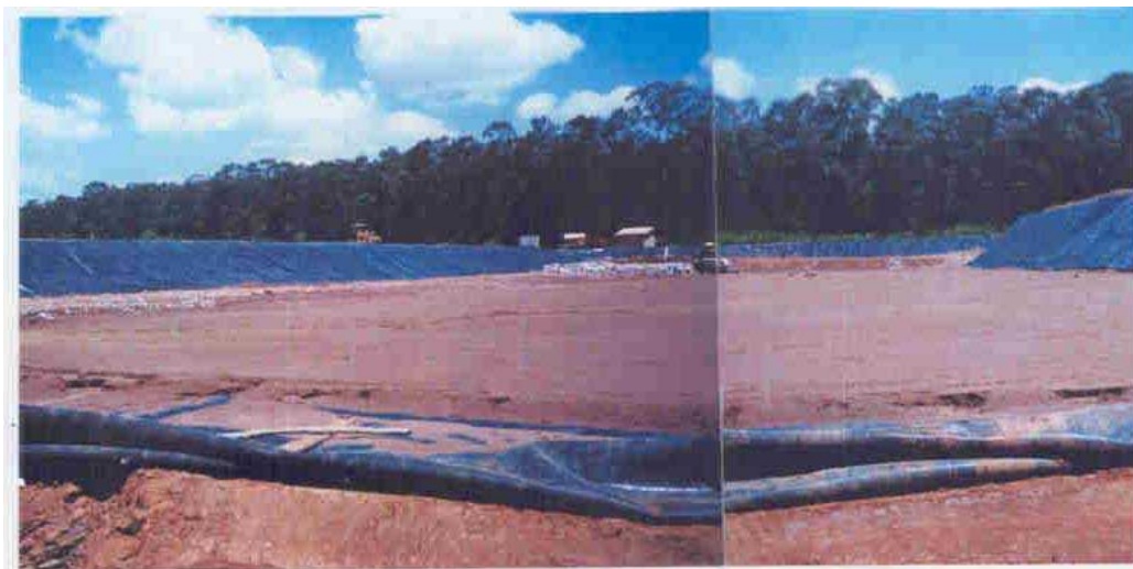
Figura 08: Mesma situação anterior numa fase mais adiantada. Instalação da geomembrana de PEAD sobre camada de solo argiloso compactado na Trincheira. Num segundo momento a instalação do sistema de drenagem das águas percoladas (Chorume) e de gás metano (biogás) em meio ao solo argiloso compactado.
