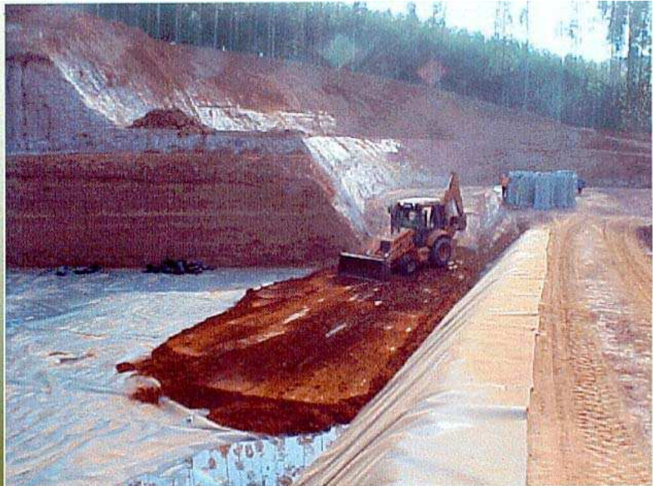
Figura 15: Aplicação de camada de solo argiloso, após a aplicação de manta de impermeabilização (geomembrana) de PEAD sobre camada e a ancoragem da mesma. Exemplo de aterro sanitário convencional em camadas, localizado em encosta.
