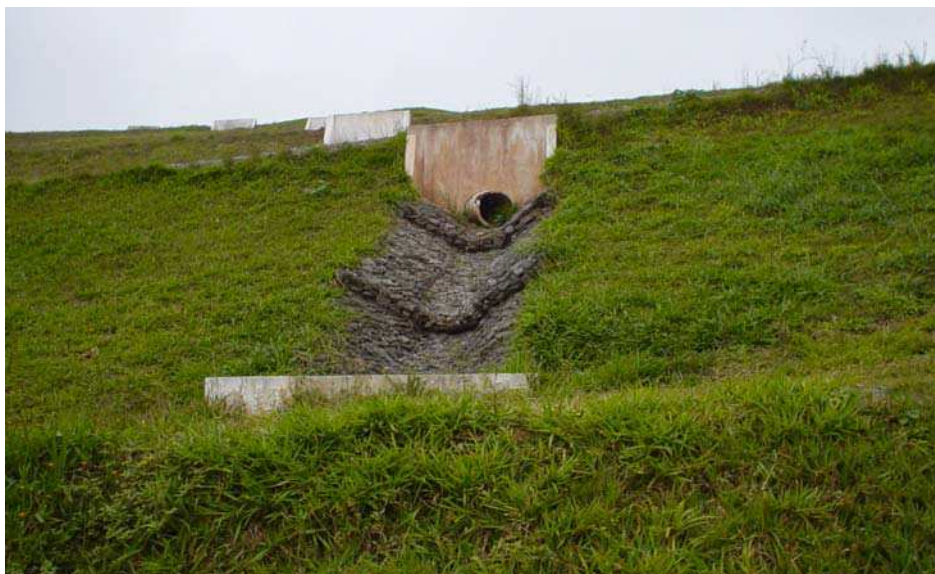
Figura 17: Exemplo de aterro sanitário convencional em camadas localizado em encosta. Observa-se o sistema de drenagem de águas pluviais. Fonte: Fernando Wolmer, 2007, CETESB, arquivo pessoal
