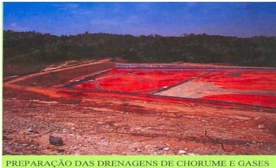
Figura 13: Após a ancoragem da manta de impermeabilização de PEAD ocorre nova aplicação de uma camada de solo argilosa e a preparação do sistema de drenagem de águas residuárias (chorume) e gases num aterro sanitário convencional de área. Fonte: Fernando Wolmer, 2007, CETESB, arquivo pessoal
