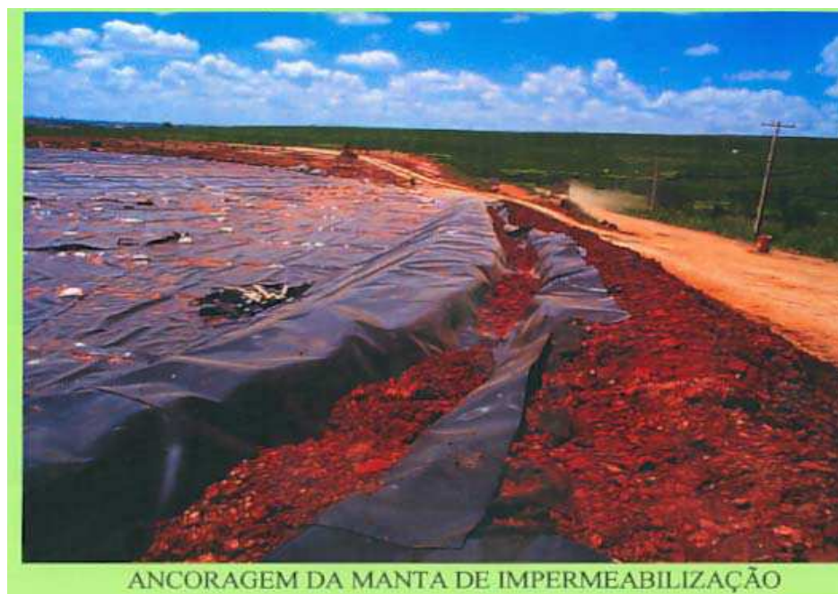
Figura 12: Após a aplicação de manta de impermeabilização (geomembrana) de PEAD sobre camada de solo argiloso compactada, ocorre a ancoragem da manta de impermeabilização no aterro sanitário convencional de área. Fonte: Fernando Wolmer, 2007, CETESB, arquivo pessoal
