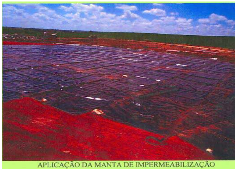
Figura 11: Aplicação da manta impermeabilização (geomembrana) de PEAD sobre camada de solo argiloso já compactada um aterro sanitário convencional de área. Fonte: Fernando Wolmer, 2007, CETESB, arquivo pessoal
