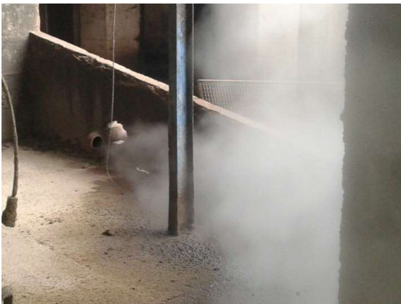
Figura 27: Coletor de saída dos purgadores instalados sob a moenda (purgadores 4, 18 e 19 conforme Anexo 1) demonstrando fluxo e perda contínua de vapor, inviabilizando acesso aos equipamentos.
