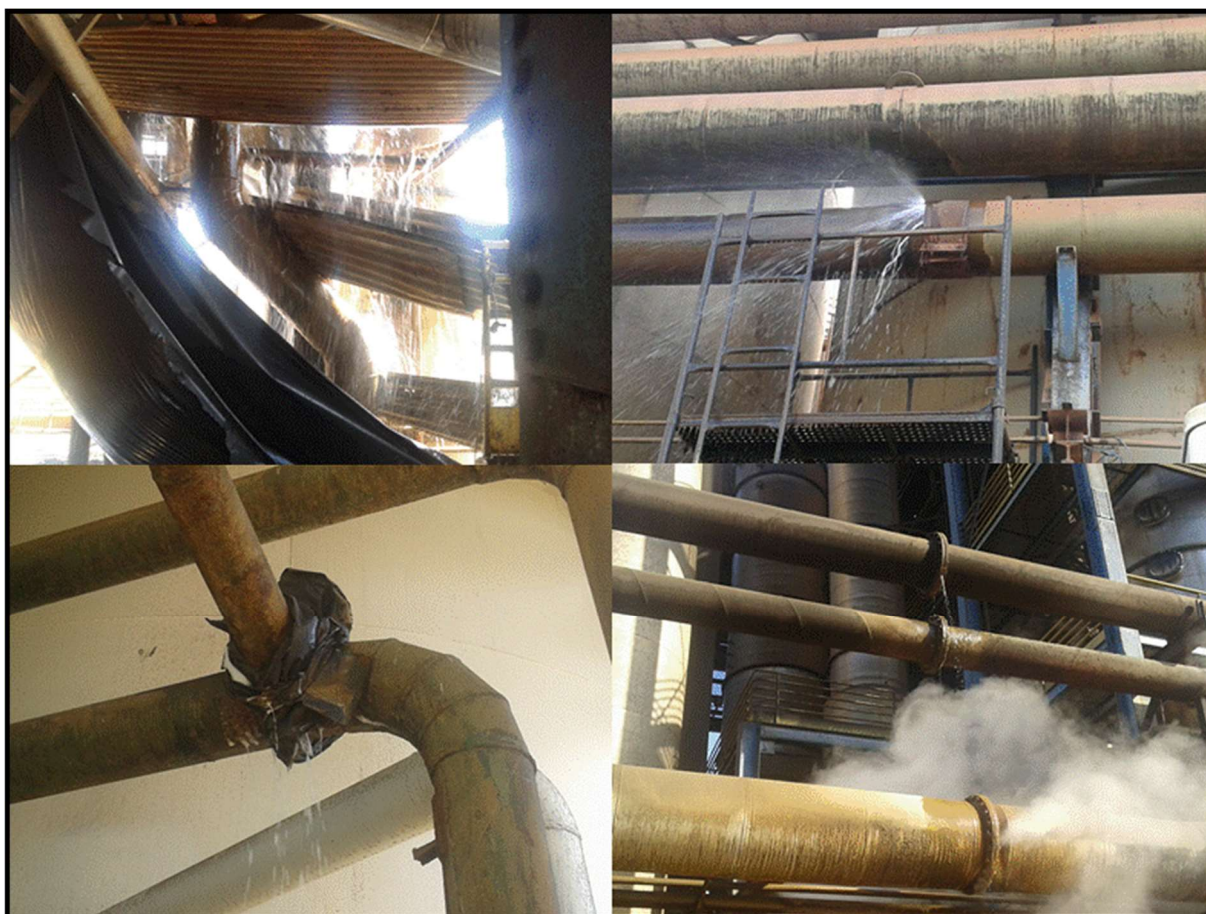
Figura 37 – Vazamentos diversos em sistemas de circulação de água de refrigeração
