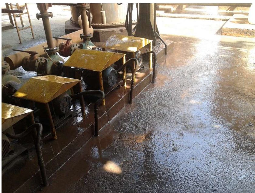
Figura 38 – Vazamentos constantes do sistema de circulação de água de refrigeração e proteção instalada em motores.
