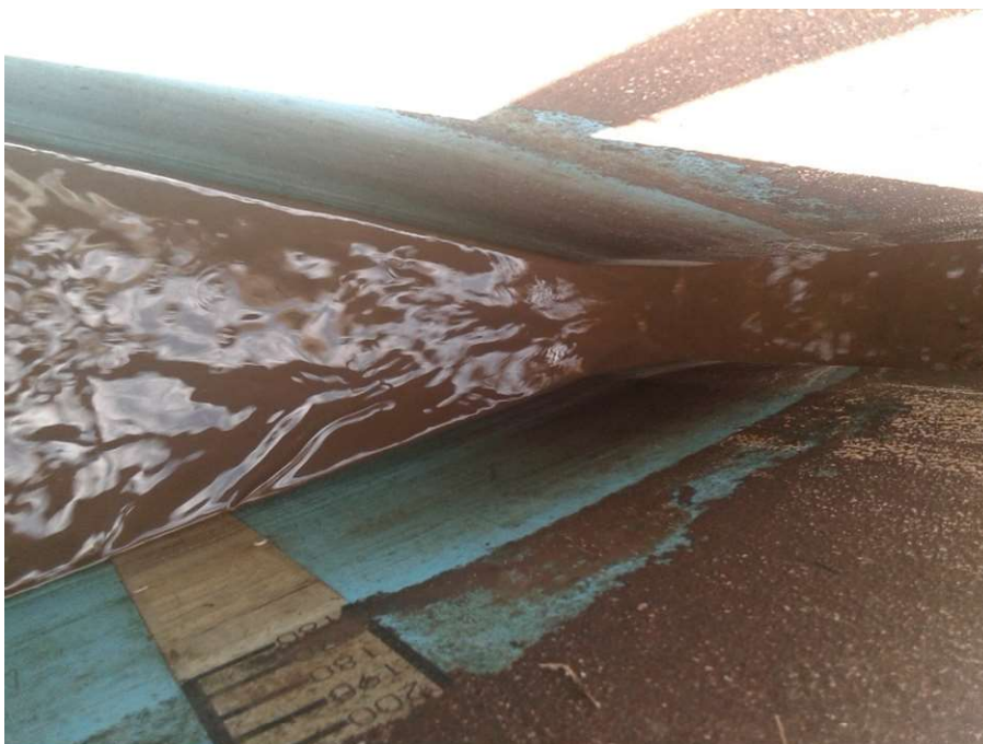
Figura 12: Calha Parshall para medição de águas residuárias, na saída da estação separadora de óleos e graxas.
