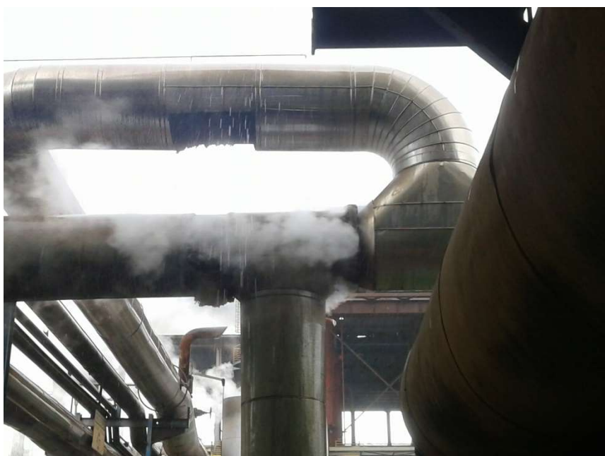
Figura 29: Rede de vapor de escape. Qualidade deficiente de isolamento térmico em tubulações de vapor. Possível ainda observar vazamentos constantes em uniões flangeadas.
