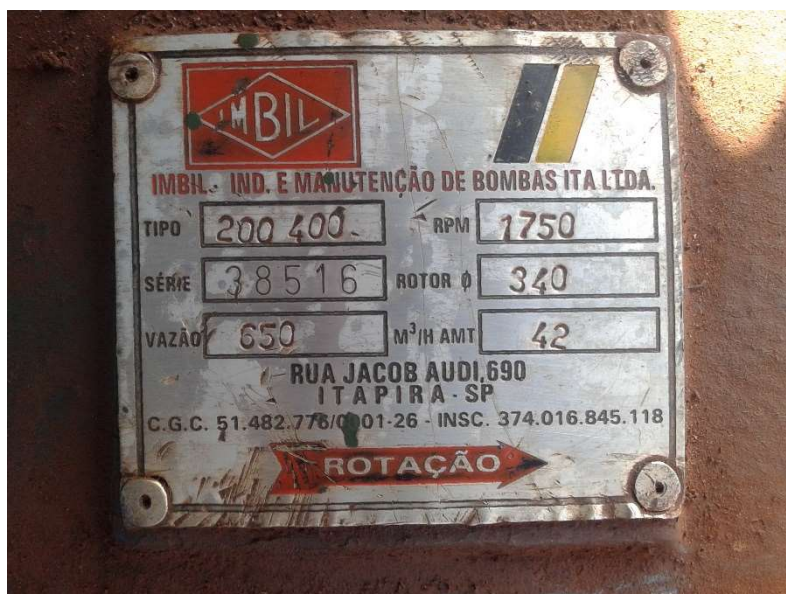
Figura 21: Dados de placa bomba de captação
