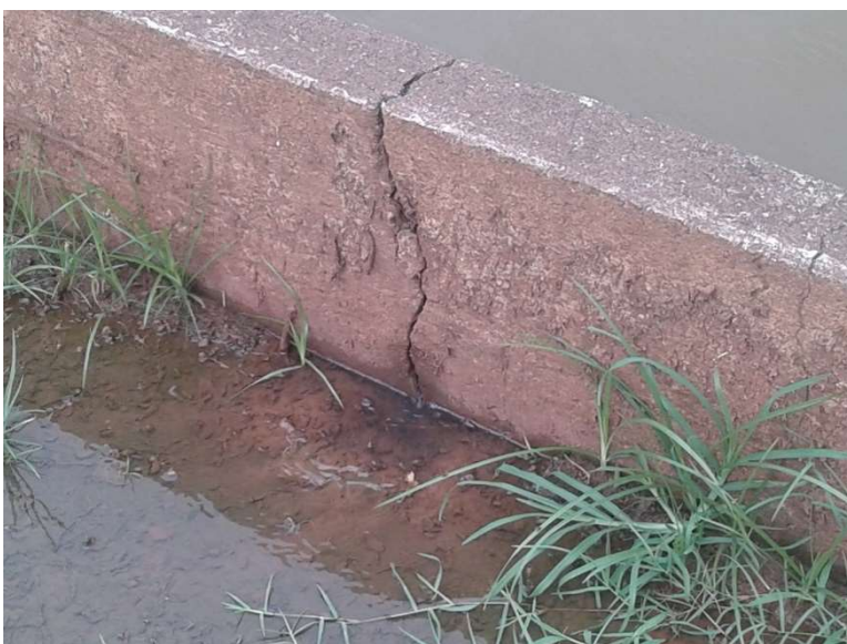
Figura 15: Vazamento em trincas da piscina de captação e aspersão.
