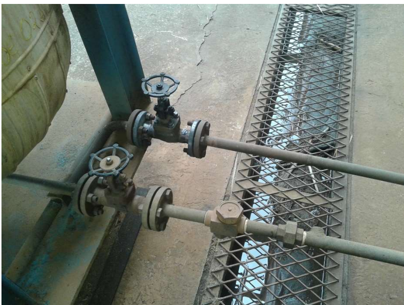
Figura 28: Tomada de vapor ao lado da estação de purga da turbina do picador 1. Tubulações sem isolamento térmico e uso de vapor em condição não prevista no projeto da usina.
