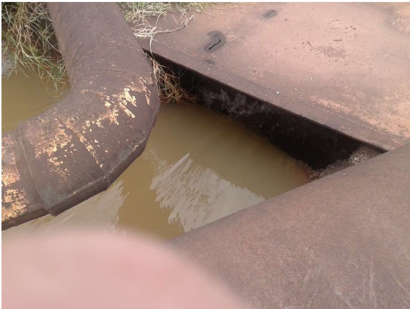
Figura 14: Transbordo de retorno da piscina de captação
