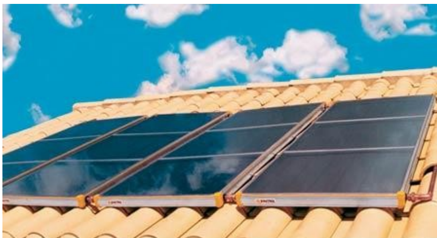
Figura 5 – Coletor Solar instalado no telhado da residência (Fonte: < www.soletrol.com.br >, 2006)
