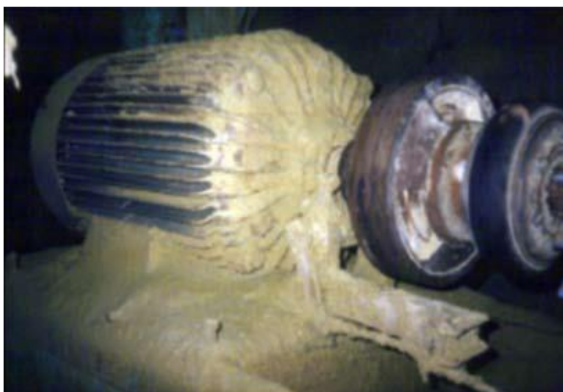
Figura 3 Motor coberto com pó.
