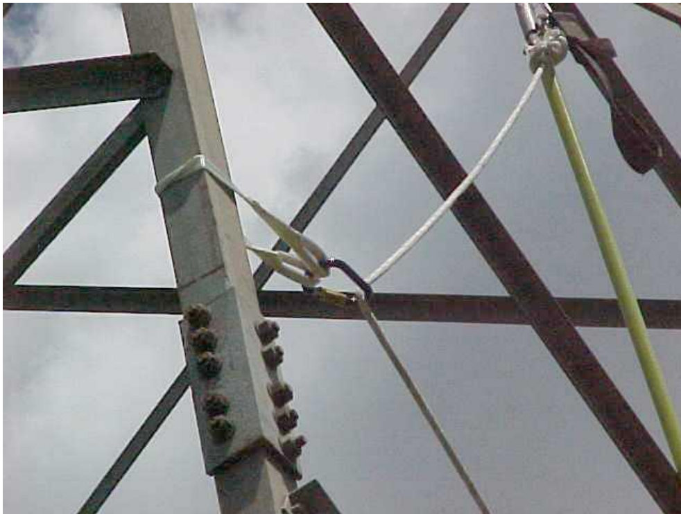
Figura 24 Ancoragem auxiliar Fonte: ISA CTEEP (2009)
