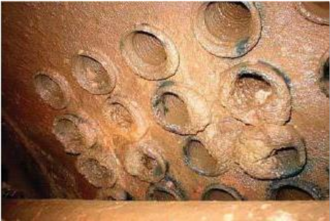
Figura 6 Caldeira aquatubular com incrustação
