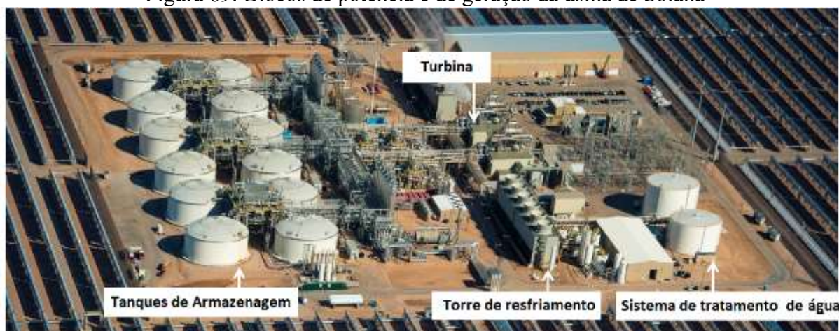
Figura 69: Blocos de potência e de geração da usina de Solana
