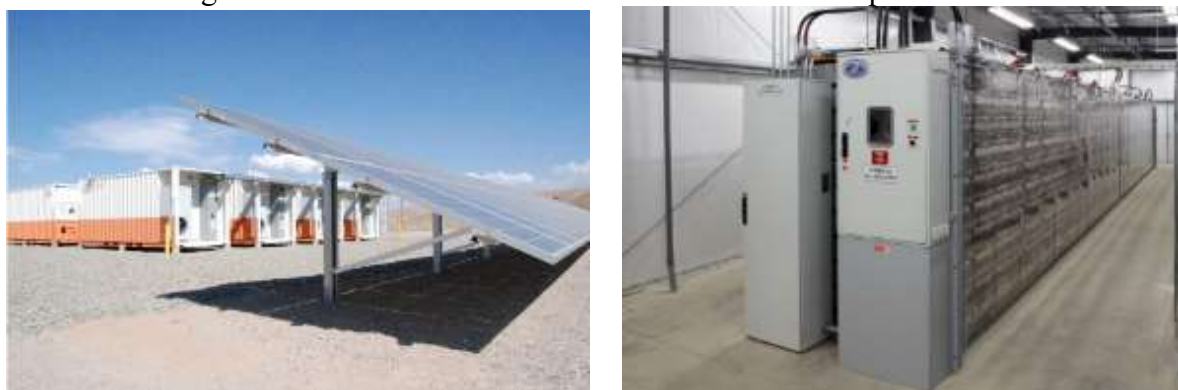
Figura 50: Sistema de armazenamento de eletricidade por baterias
