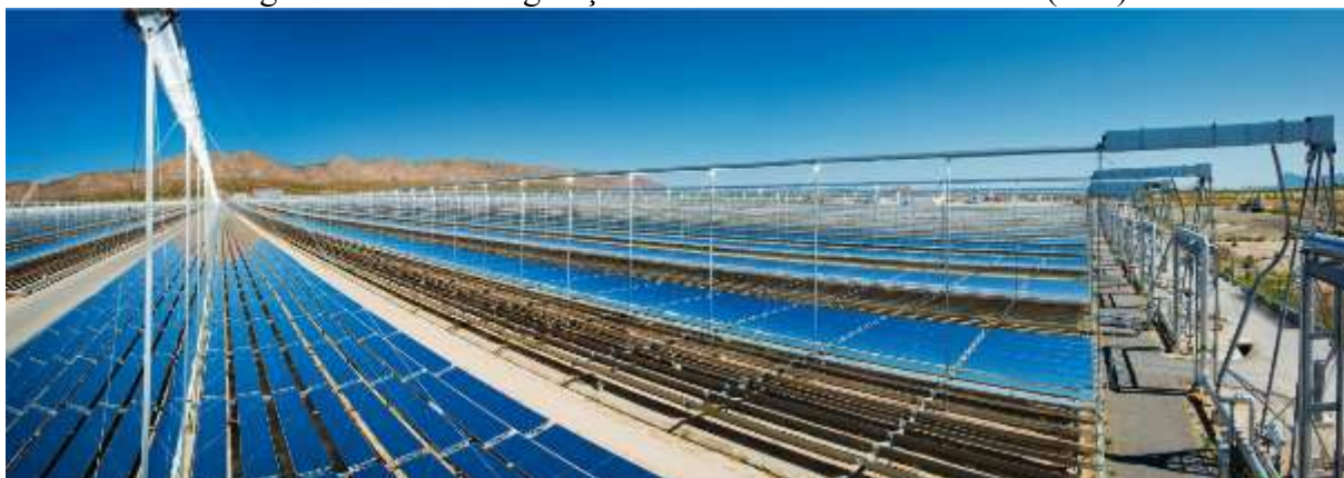
Figura 88: Bloco de geração da usina de Puerto Errado 2 (PE2)
