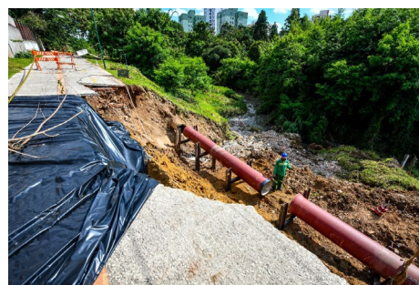
Figura 29 – Queda de uma ciclovia na zona sul em decorrência de chuva.
