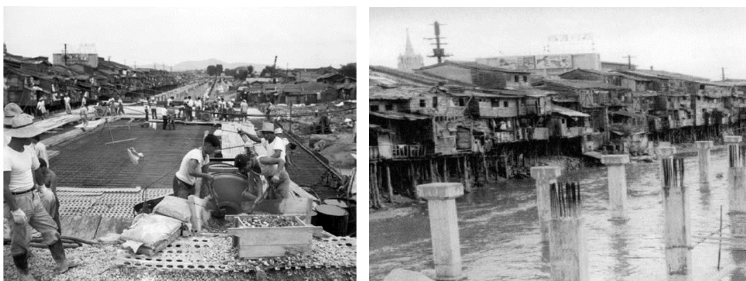
Figura 5 - Processo de construção das lajes sobre o córrego e obras abandonadas.
