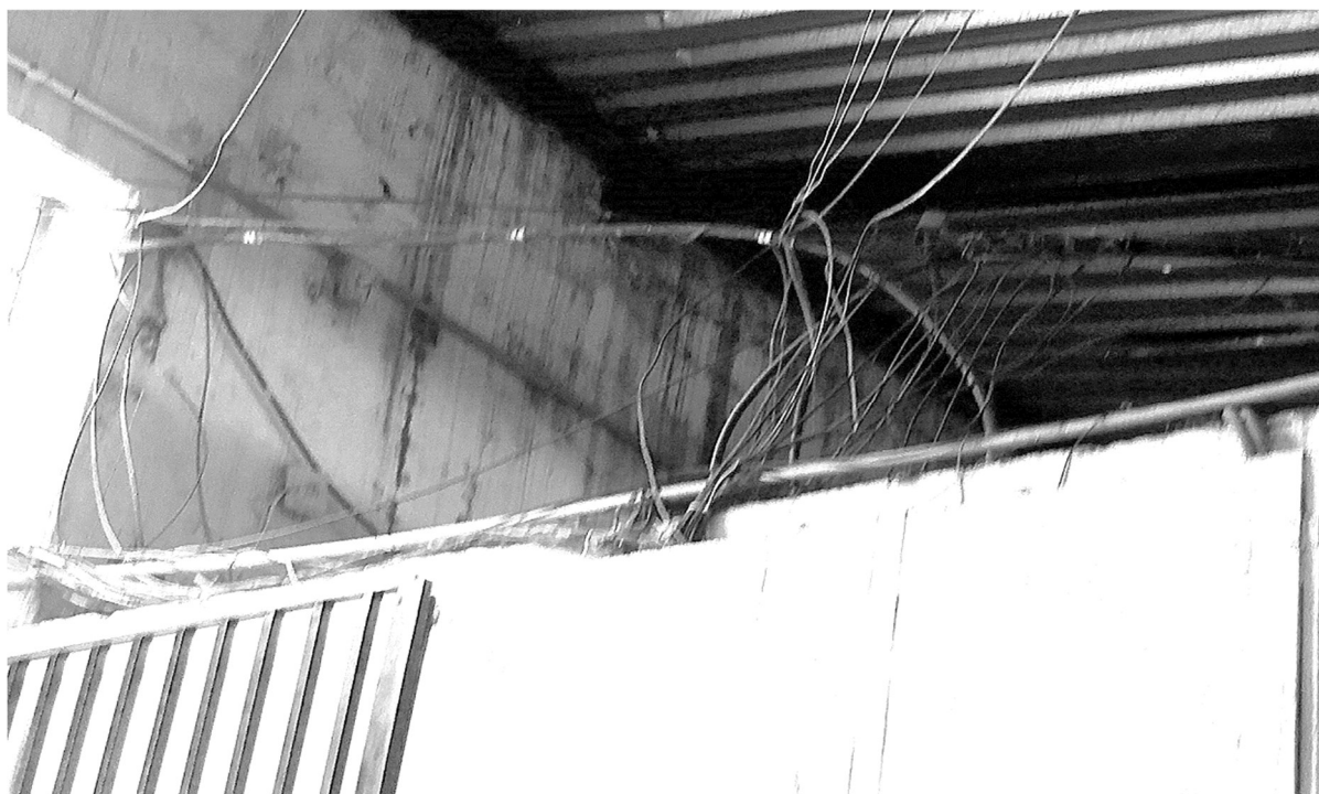
Figura 82 - Constatando a Precariedade das Instalações
