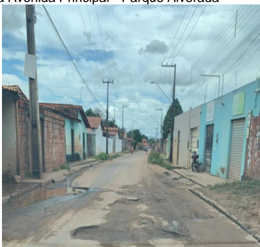
Figura 13 - Asfalto danificado na Avenida Principal - Parque Alvorada
