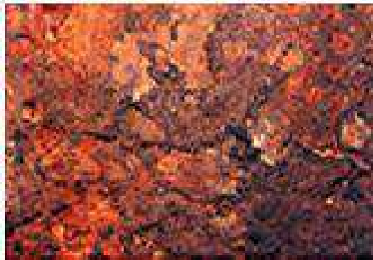
Figura 5: Corrosão uniforme 1.3.1 (Fonte: Metálica, 2013)
