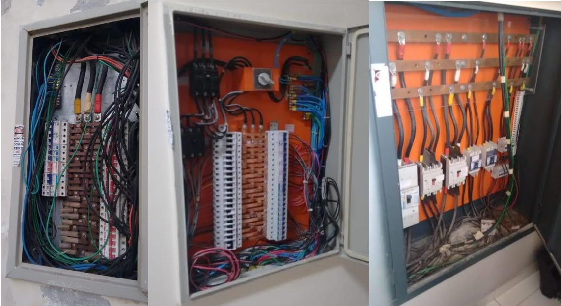
Figura 8 Quadros de força
