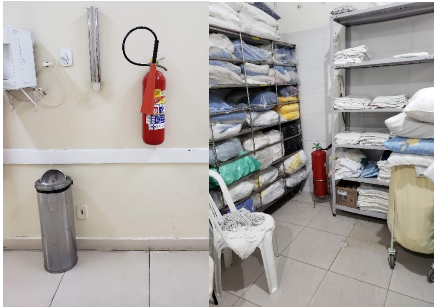
Figura 14 Extintores de Incêndio
