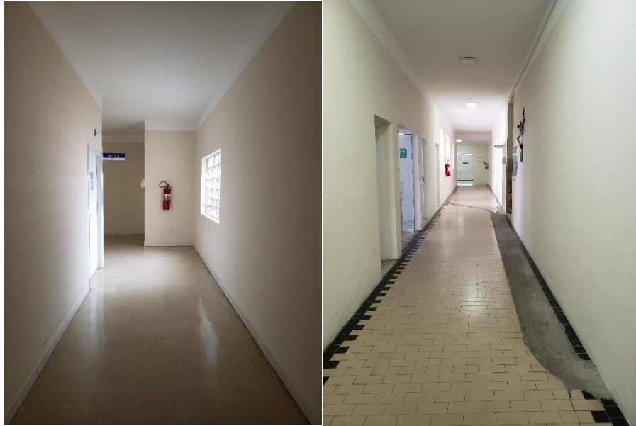
Figura 11 Falta de Sinalização
