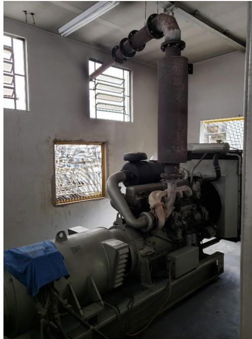
Figura 10 Gerador de energia
