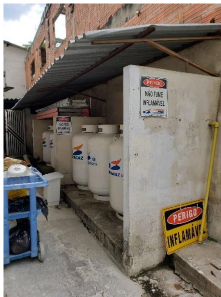
Figura 17 Central de GLP
