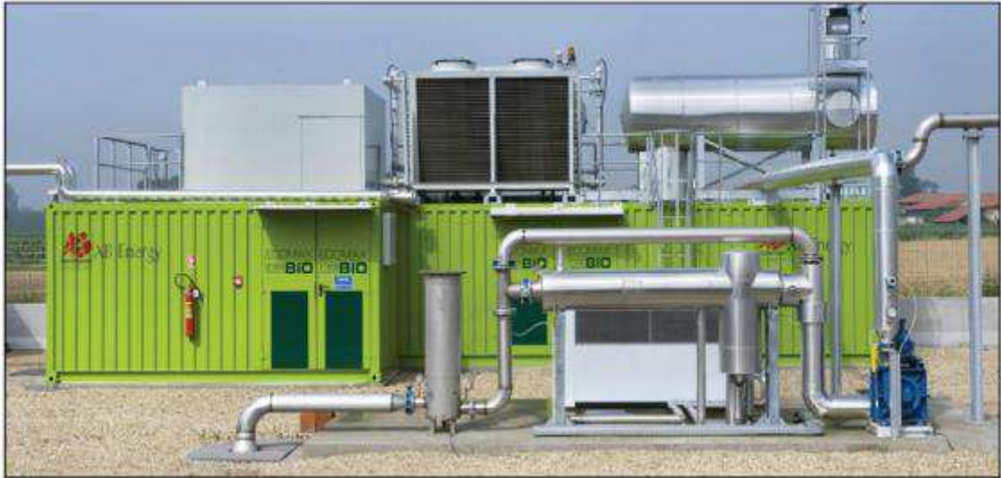
Figura 22: Contêiner com motor gerador instalado de 1,407 MW.
