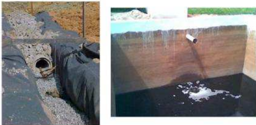
Figura 7: Dreno e tanque de chorume. (Fonte: SANTEC RESÍDUOS, 2005).
