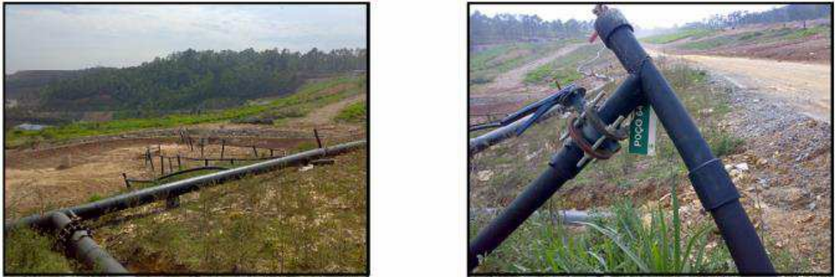
Figura 11: Sistema de captação de biogás, tubulações e poço. (Fonte: TERMOVERDE CAIEIRAS, 2017).
