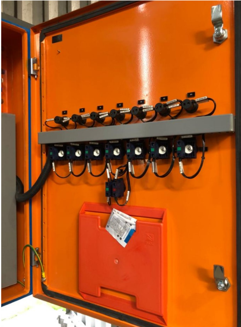
Figura 56 - Interligação das chaves com sinalizações
