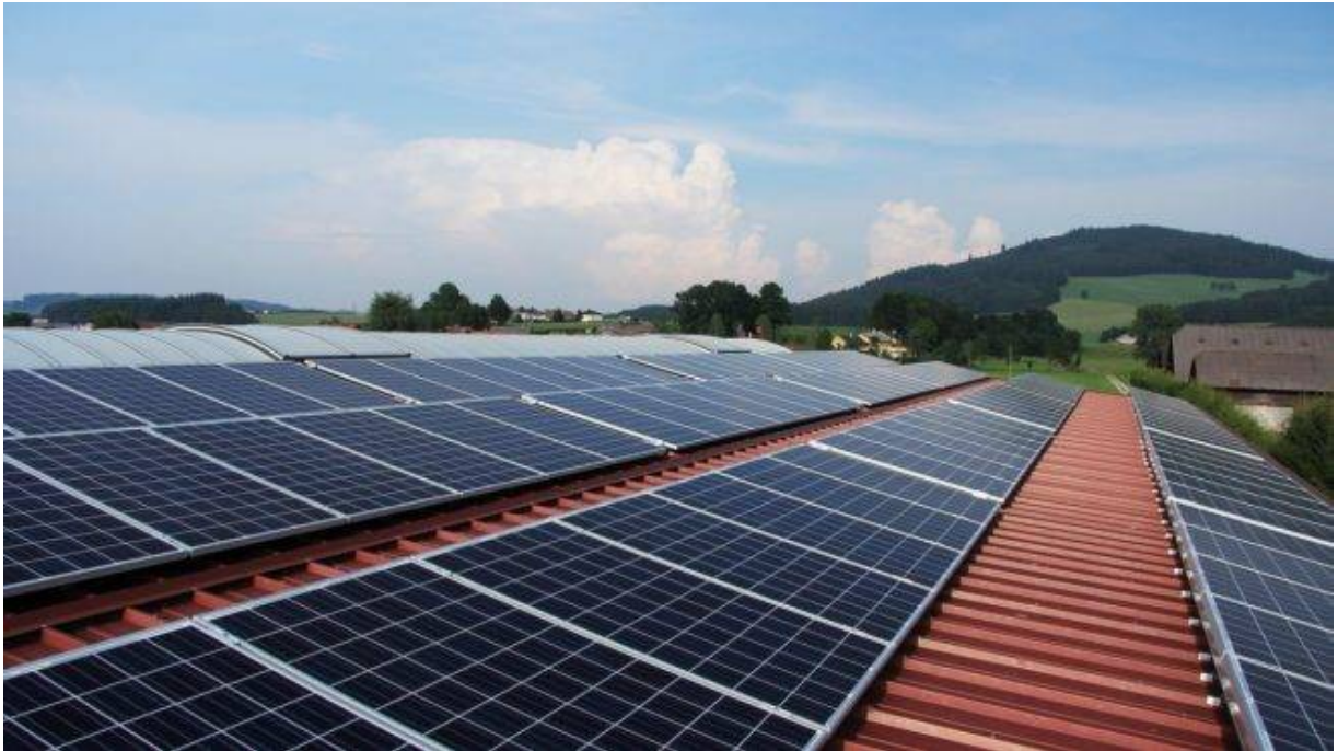
Figura 29 - Módulos fotovoltaicos instalados sobre uma residência
