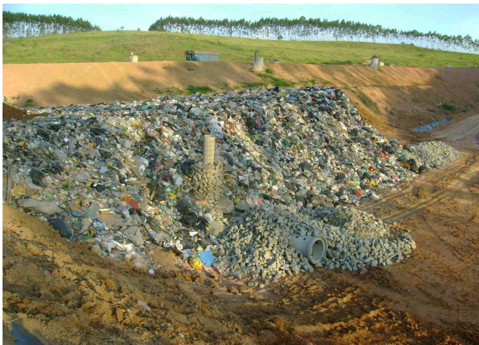
Figura 10 – Dutos de Gás e Chorume
