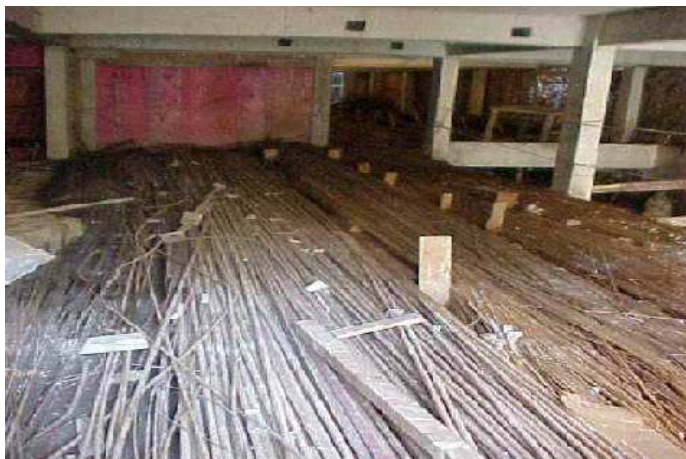
Figura 12: Estado Inicial (EMPRESA B): Desorganização no armazenamento
