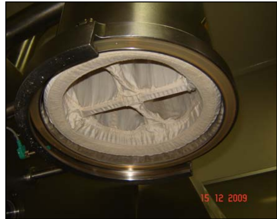
Figura 3.22 - Filtro instalado na câmara do leito.
