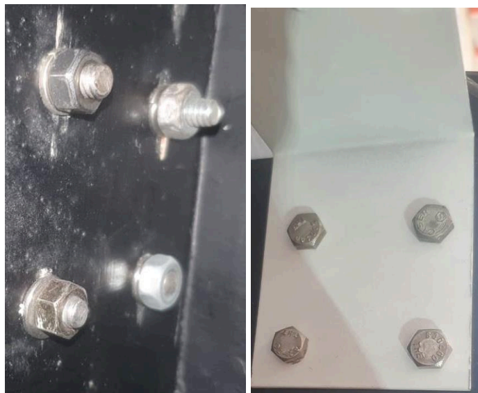
Figura 29 – Fixação do Pluviômetro
