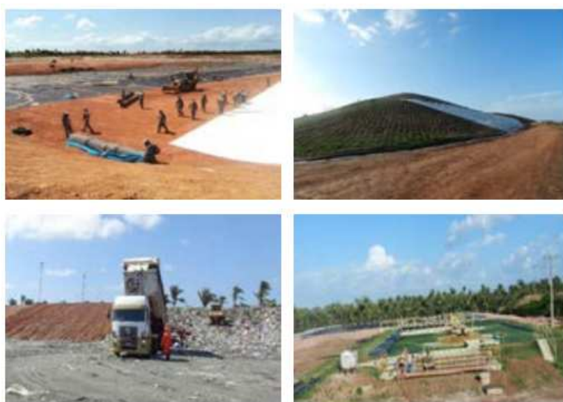
Figura 1: Aterro Sanitário Titara
