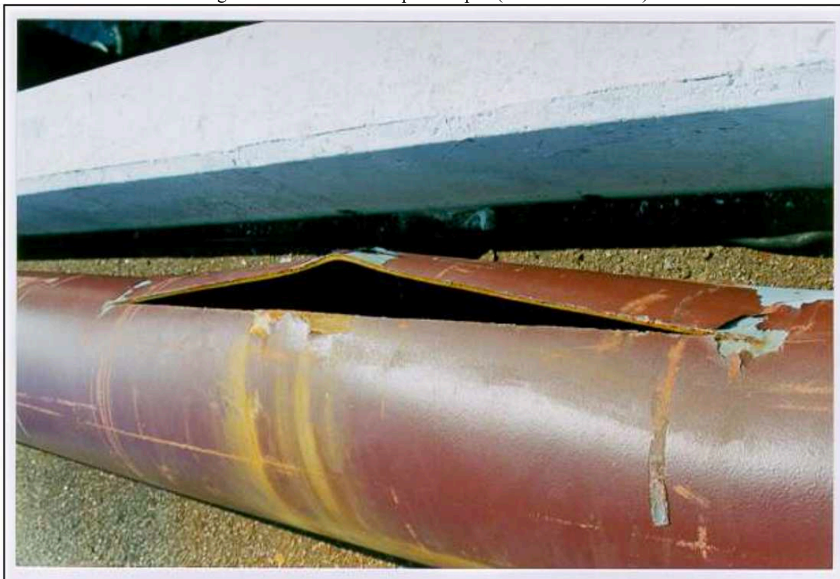
Figura 42- Vista do Tubo que Rompeu (Linha de LCO 12")
