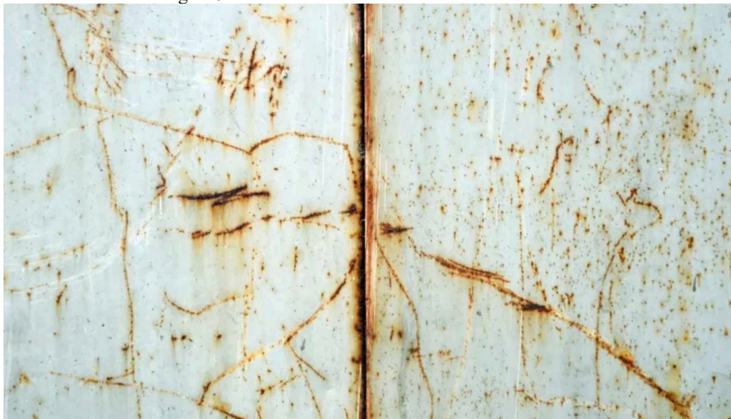
Figura 9- Corrosão Filiforme Sobre Alumínio
