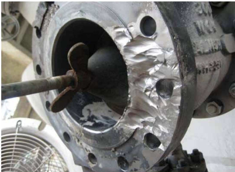
Figura 10- Corrosão-erosão de um Flange em Aço 11/4 em uma Linha da Unidade de Craqueamento Catalítico Fluido
