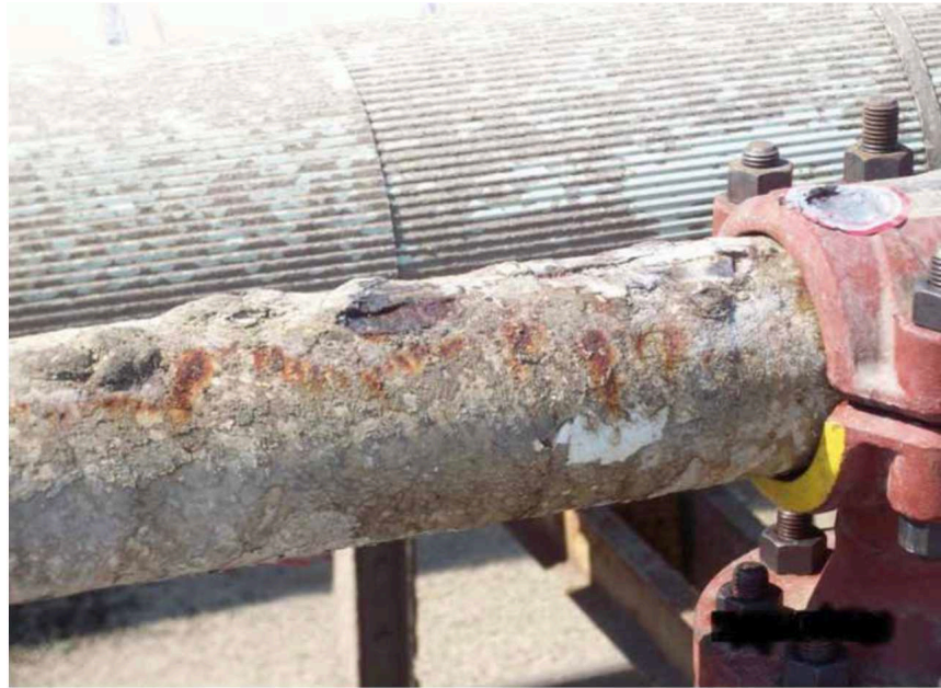
Figura 7- Corrosão Atmosférica em uma Linha de GLP Próxima a uma Torre de Resfriamento
