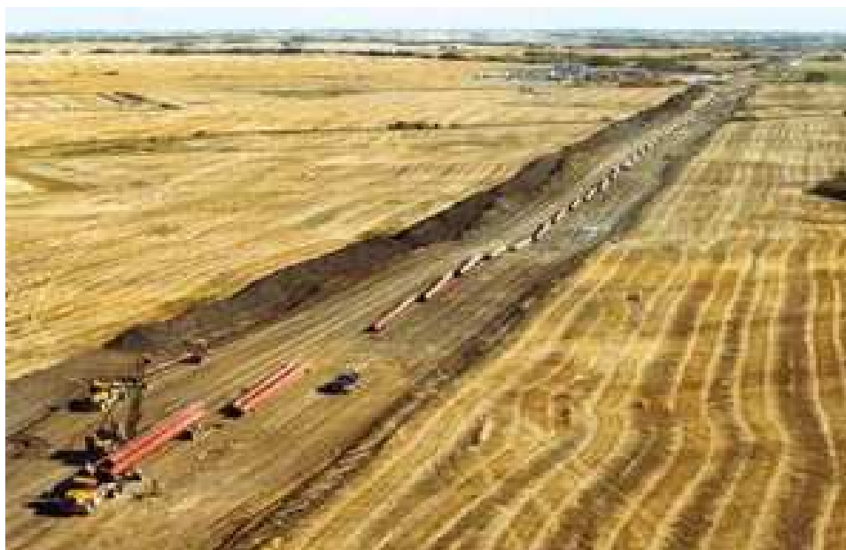
Figura 26 Gasoduto em alinhamento Fonte: NGSA, USA
