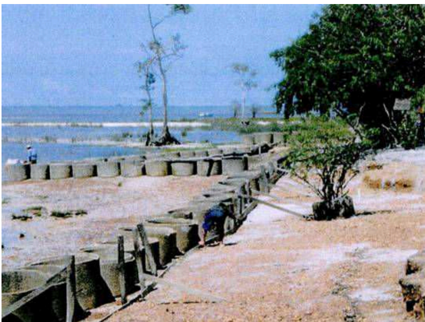
Figura 24 – Manilhas de concreto e sedimentos de aterro ao longo da orla Fonte: M. C. BEVILAQUA, 2008
