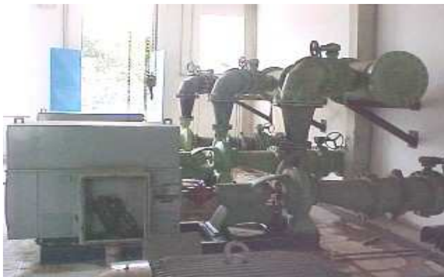
Figura 17 - Sistema de bombeamento da distribuição de água para São Sebastião (Fonte: Sabesp, 2004)
