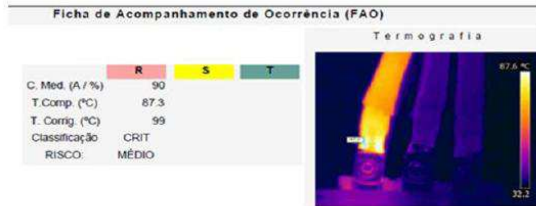
Figura 17 - Termograma obtido dos cabos do quadro de seccionamento da prensa industrial (Spohr, Franken, Steffenello, Steffenello, & Paluchowski, 2011).
