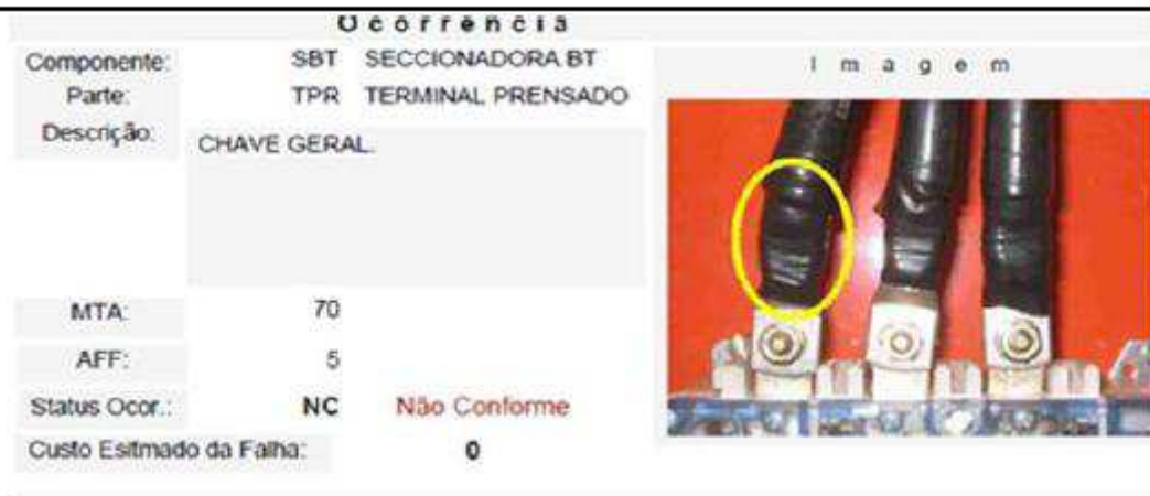
Figura 16 - Cabos do quadro de seccionamento da prensa industrial (Spohr, Franken, Steffenello, Steffenello, & Paluchowski, 2011).
