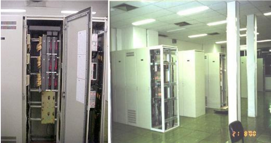
Figura 51 - Gabinetes e cartões do sistema digital de controle distribuído
