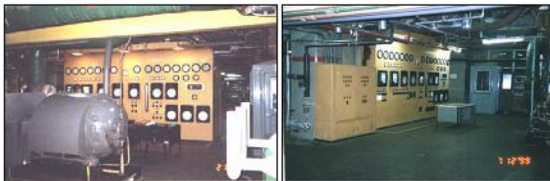
Figura 25 - Painel da alimentação e condensado
