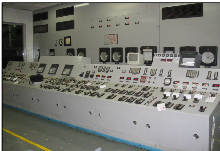
Figura 30 - Sala de controle mecânico
