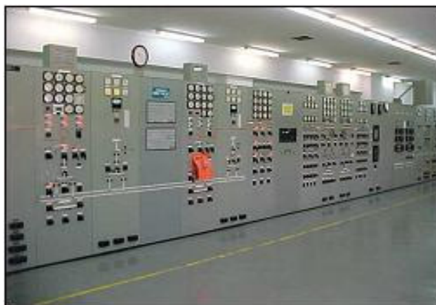
Figura 27 - Sala de controle elétrico das unidades geradoras 1 a 4
