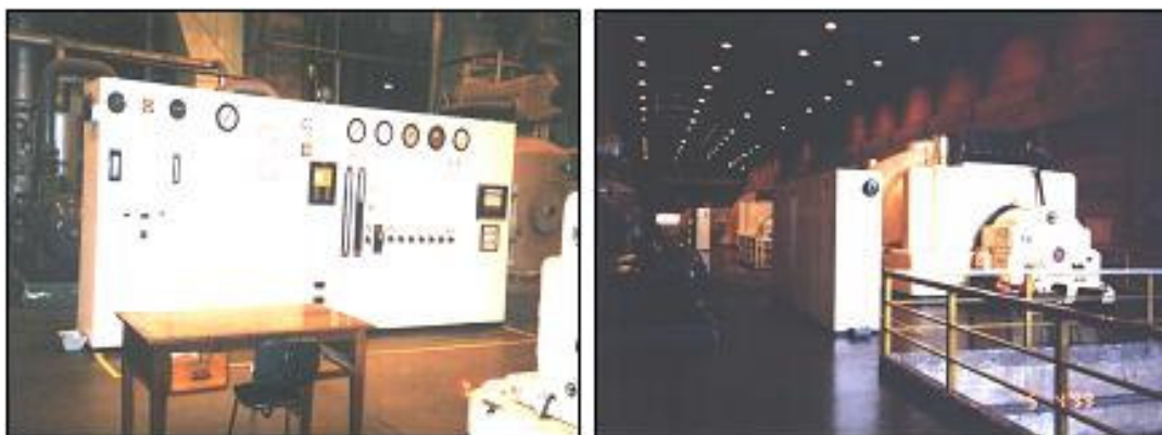
Figura 26 - Painel da turbina
