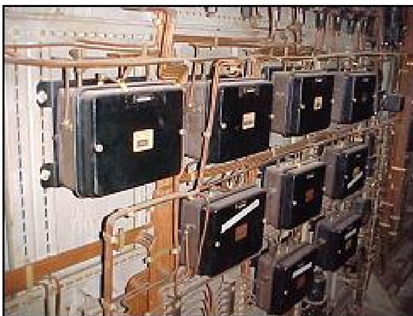
Figura 29 - Rede de tubulações de sinais para os controladores Mine-Line
