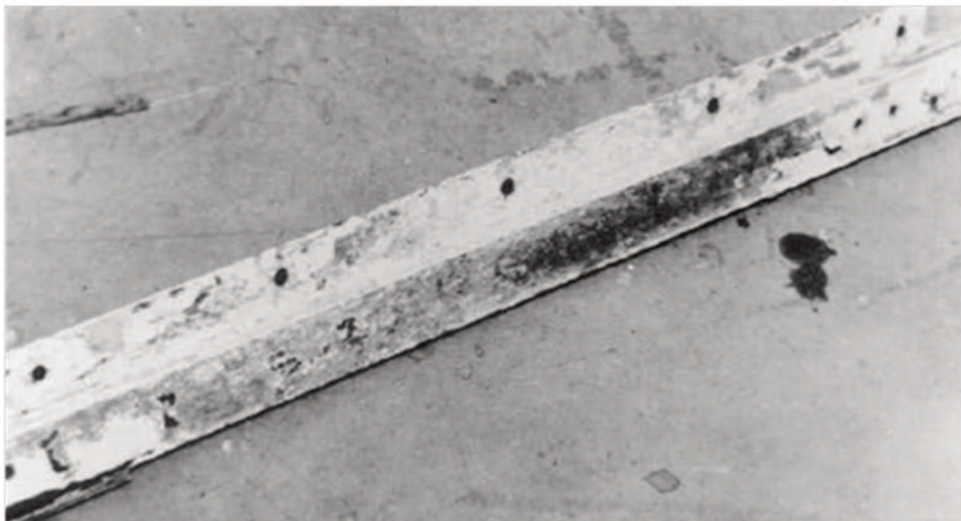
Figura 1 - Corrosão uniforme. Fonte: FAA AC 43-4A, 1991.
