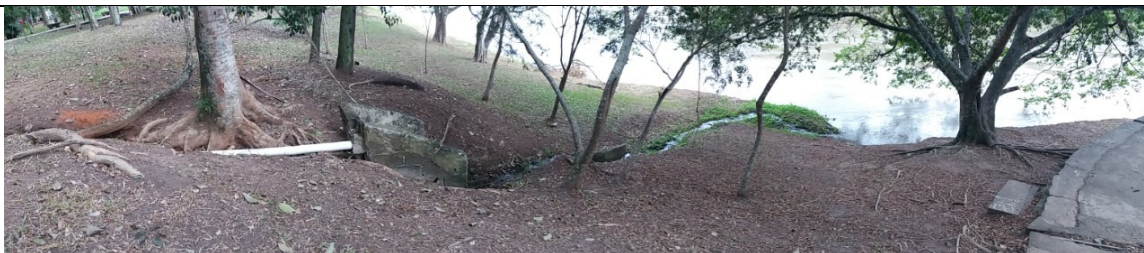
Figura 17-foto 9-Canalização de Água Exposta Fonte: Souza 1 - 2018
