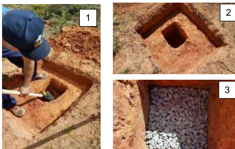
Figura 11: Preparo do local para realização do teste de permeabilidade. A partir do nivelamento do terreno foi cavado um buraco de 30X30 cm (1) e (2). Após o buraco estar feito nas devidas proporções, colocou-se a brita (3).
