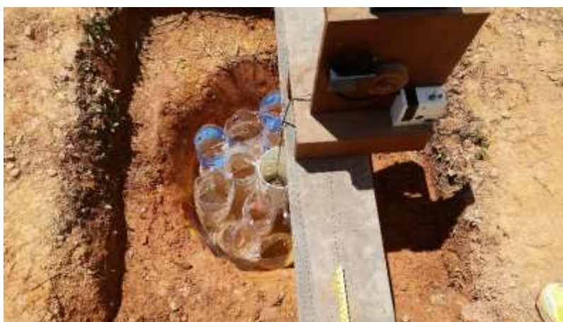
Figura 19: Sumidouro instalado no solo, cheio de água e o equipamento de medição do nível de água instalado sobre a estrutura.
