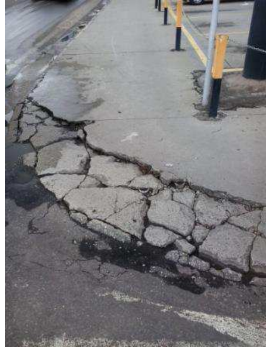
Figura 25: Exemplo de calçada danificada (Av. Independência) Fonte: Fotografado pela autora (2014)
