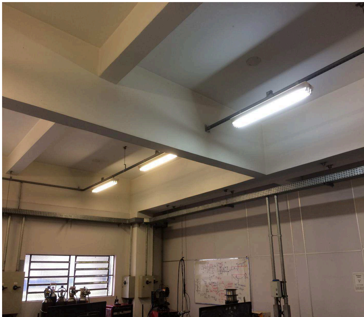
Figura 10 - Seiketsu locais instalação ventiladores
