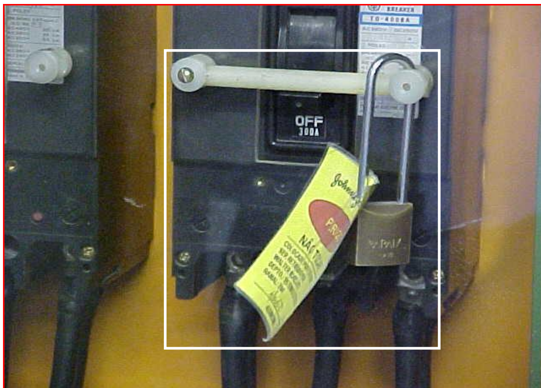
Figura 6 Vista frontal do painel elétrico com travamento correto.
