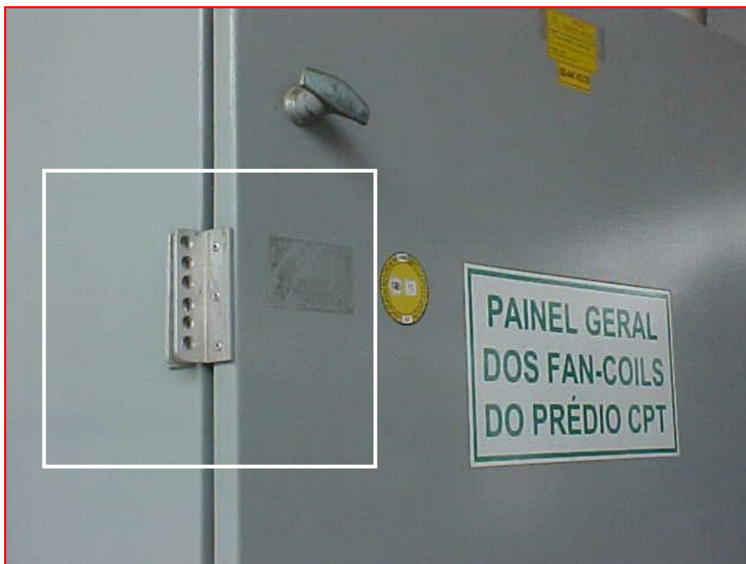
Figura 8 Foi instalada uma trava para “ lock out/ tag out ” na lateral do painel.
