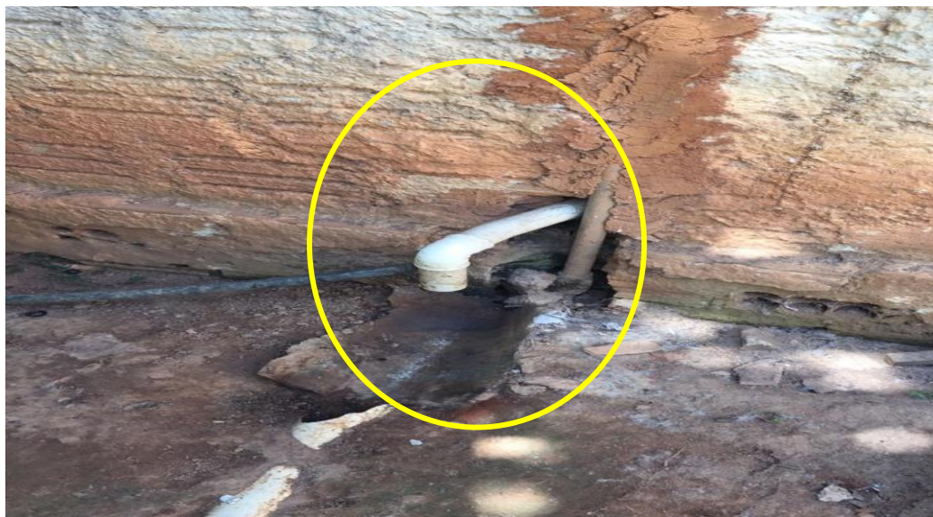
Foto 01: Encanamento de esgoto desembocando em local irregular
