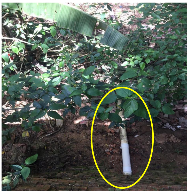
Foto 04: Encanamento de esgoto desembocando nas margens e leito do córrego
