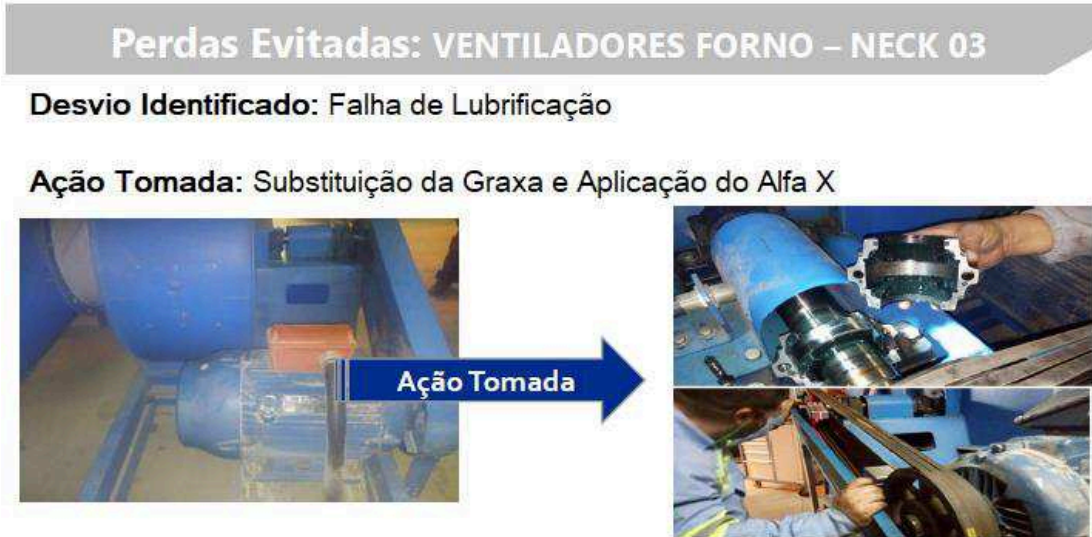
Figura 32 - Resumo da Ação Tomada no Ventilador
