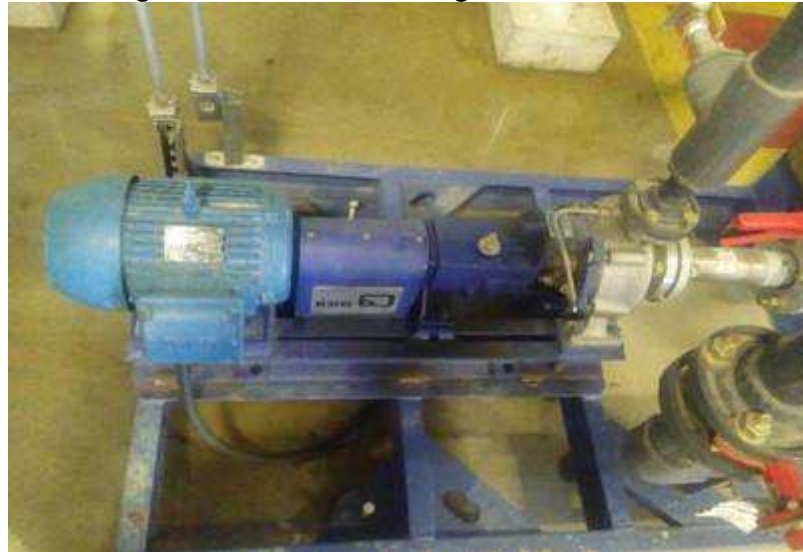
Figura 24 - Bomba Centrífuga Analisada
