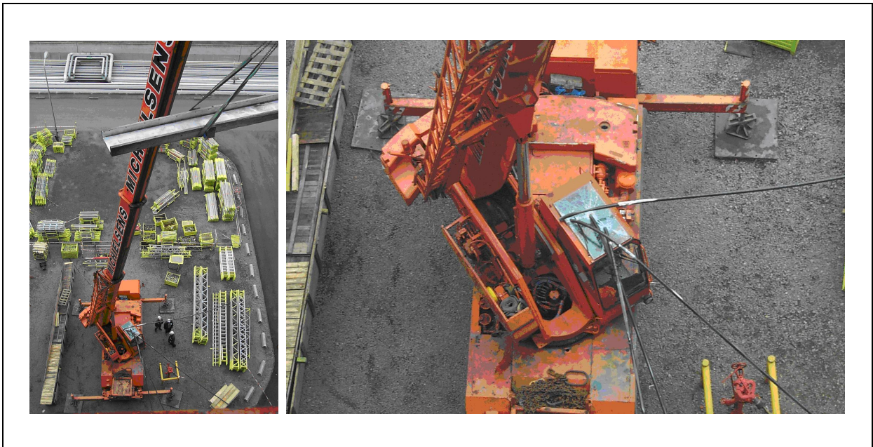
Fig. 75 – Acidente com Carga
