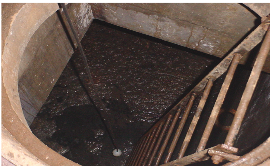
Figura 5 Presença de esgoto doméstico.
