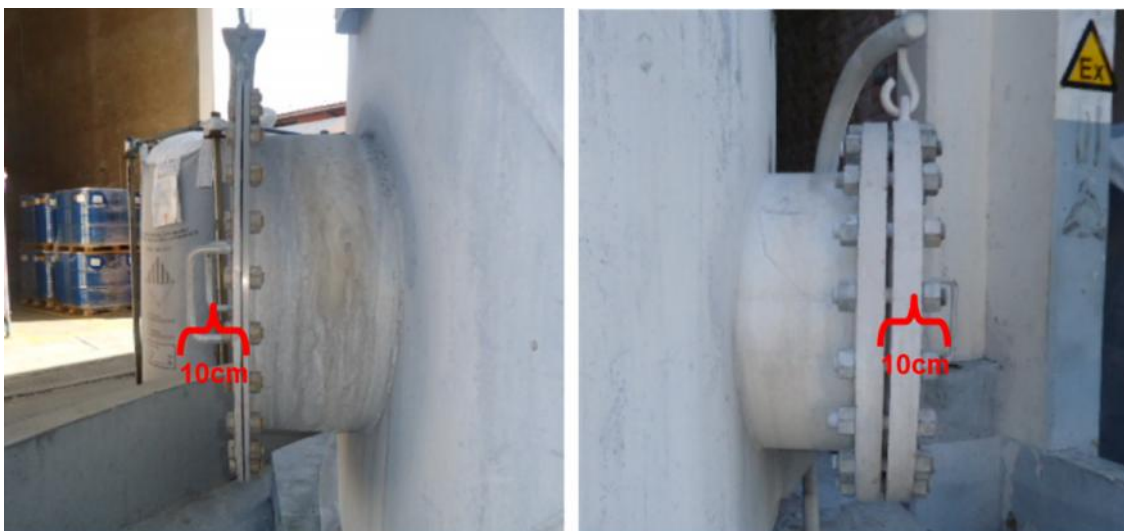
Figura 3: Indicação da abertura parcial da boca de visita lateral
