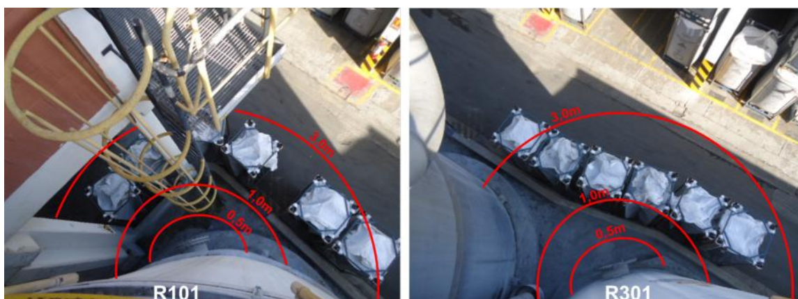
Figura 4: Pontos de monitoramento de explosividade
