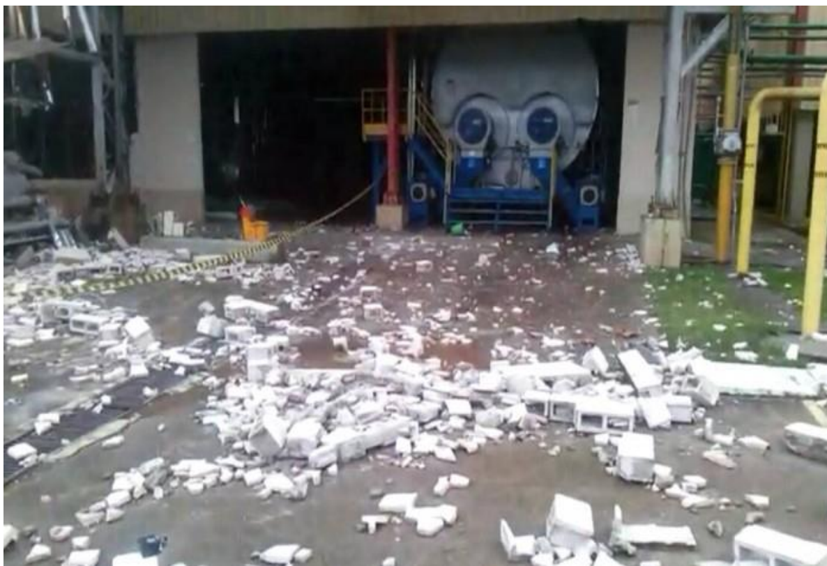
Figura 3 Setor de caldeiras após explosão II Fonte: O Globo, 2016.
