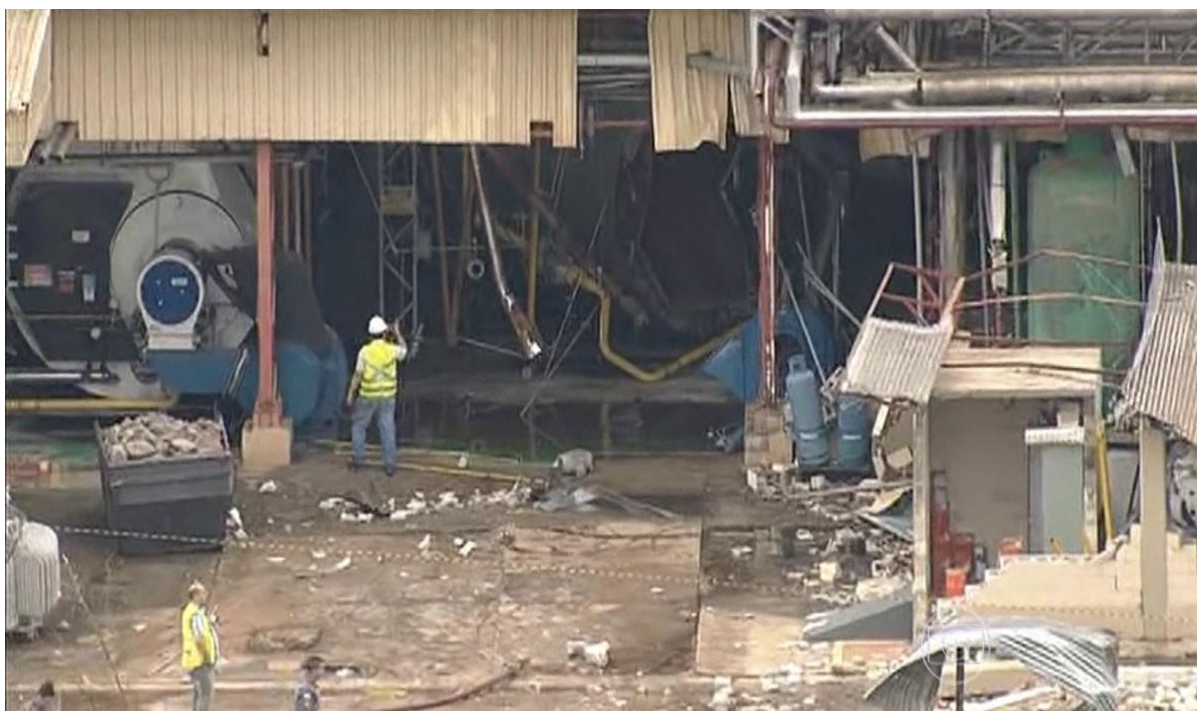
Figura 2 Setor de caldeiras após explosão I Fonte: Globo Comunicação e Participações S.A., 2016.
