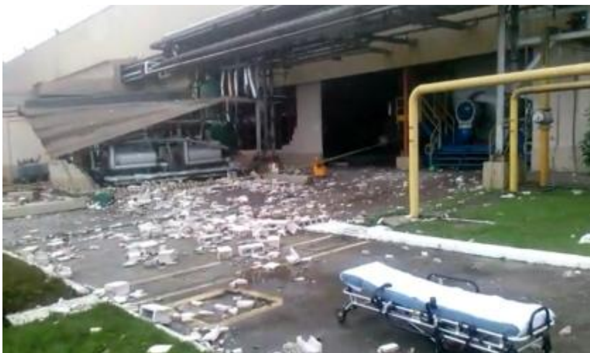
Figura 4 Desabamento de parte do telhado do setor de caldeiras. Fonte: Jornal 'O Vale', 2016.
