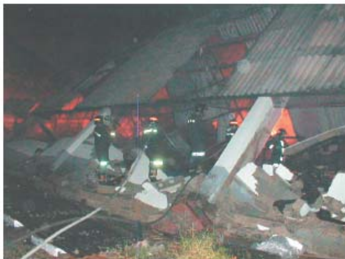
Figura 9 Colapso estrutural durante Incêndio
