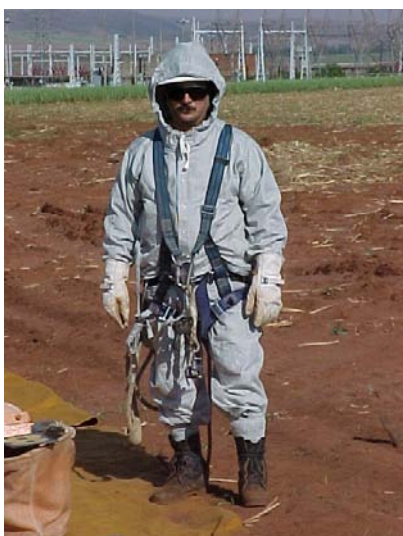
Figura 4 - Eletricista C com a vestimenta condutiva preparado para escalar a estrutura Fonte: CTEEP, 2001
