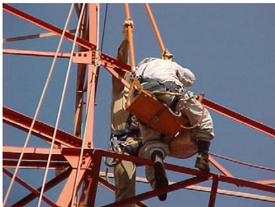
Figura 5 - Saída do eletricitista C sobre a cadeirinha e posicionamento do moitão para fixação do rabicho Fonte: CTEEP, 2001
