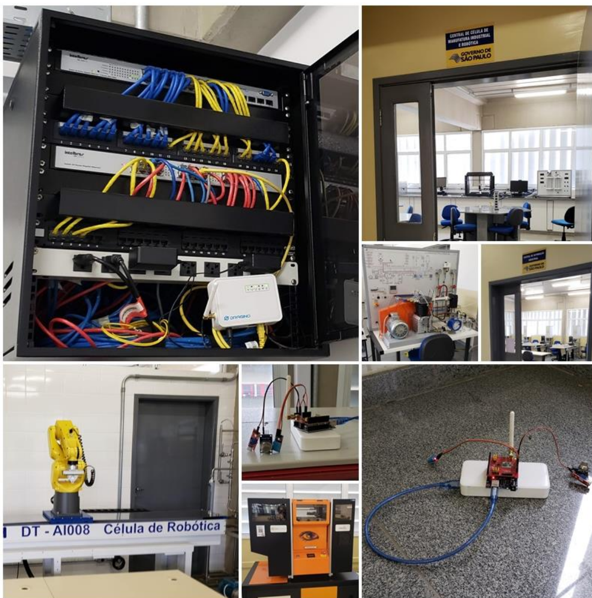
Figura 3.3 – Rack onde foi instalado o gateway de comunicação LoRa e locais de alocação de sensores e atuadores.
