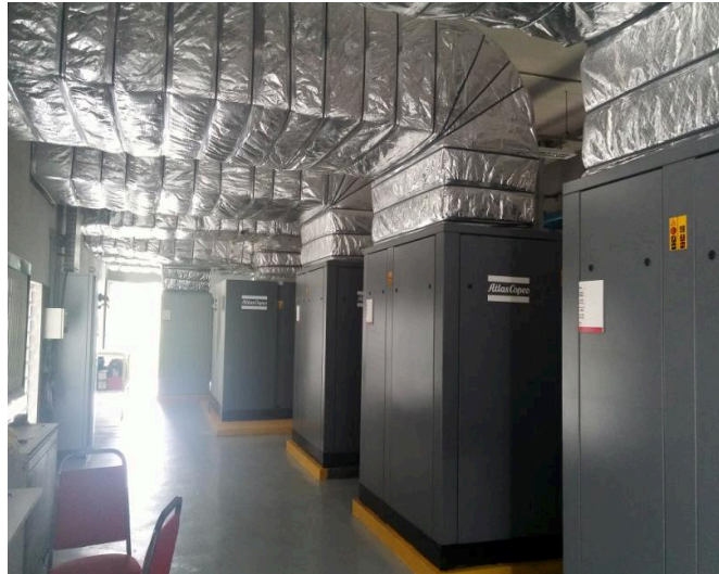
Figura 20: Isolantes térmicos sobre os dutos de ar
