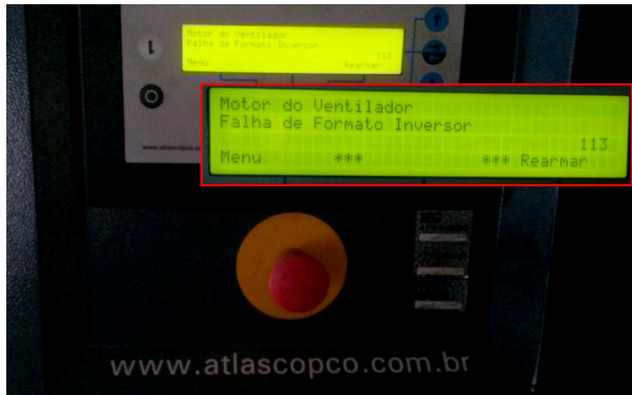
Figura 17: Compressor de ar com mensagem de erro
