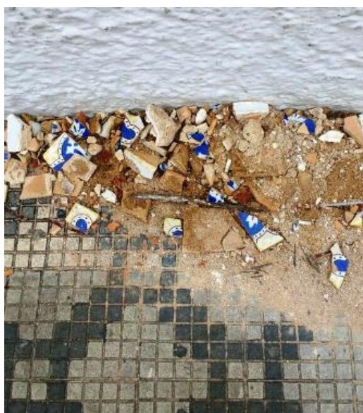
Figura 48 - Azulejos quebrados da Residência Oliveira Costa
