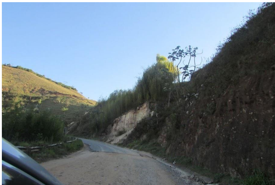
Figura 25: Acesso ao PNSB: Precariedade na pavimentação - Imagem feita por Eloísa Bussi Fernandes
