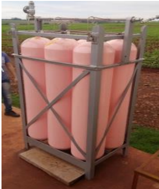
Figura 71 - Cilindros de armazenamento de biometano da Granja Haacke
