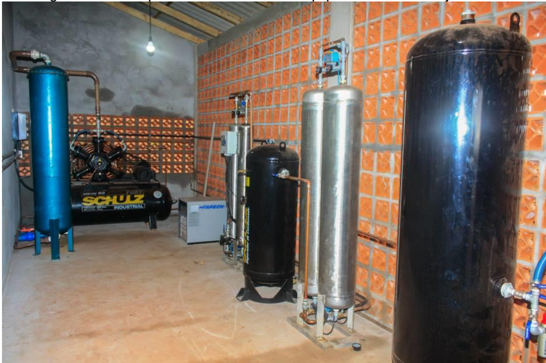
Figura 72 - Vista panorâmica da sala de equipamentos da Granja Haacke
