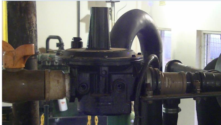
Figura 19 - Válvula Maxitrol de controle de pressão de abastecimento de biogás do Condomínio Ajuricaba
