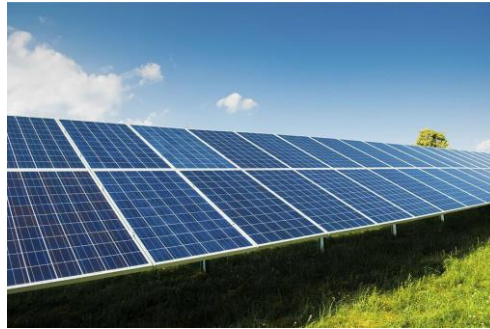
Figura 56. Imagem representativa das placas fotovoltaicas - Fonte: google.com.br
