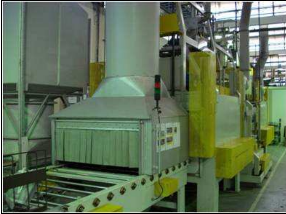
Figura 24 – Vista geral do Forno de Tratamento térmico BehrOxal®
