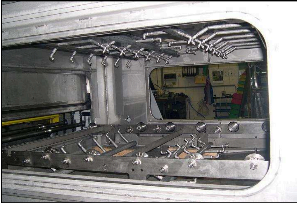
Figura 25 – Vista interna das duchas do forno de tratamento térmico BehrOxal®
