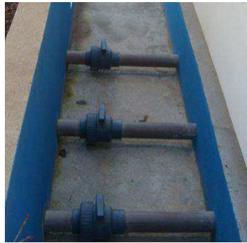
Foto 5: Dreno dos tanques de decantação. Fonte: Acervo pessoal.
