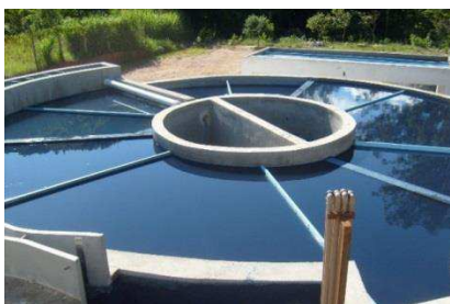
Foto 1: Tanque de decantação e filtração. Fonte: Acervo pessoal.
