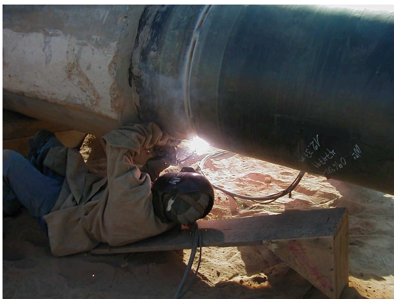
Figura 2 – Soldagem circunferencial manual de campo na construção de um gasoduto (fonte: autor)
