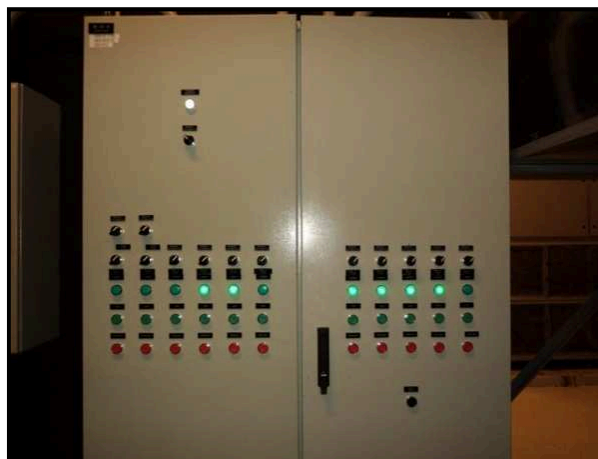
Figura 22 – Painel Elétrico do Fancoil 1 Fonte: RECORD (2010)
